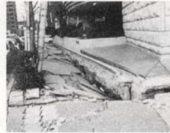
立入注意 (地割れの影響はない)
